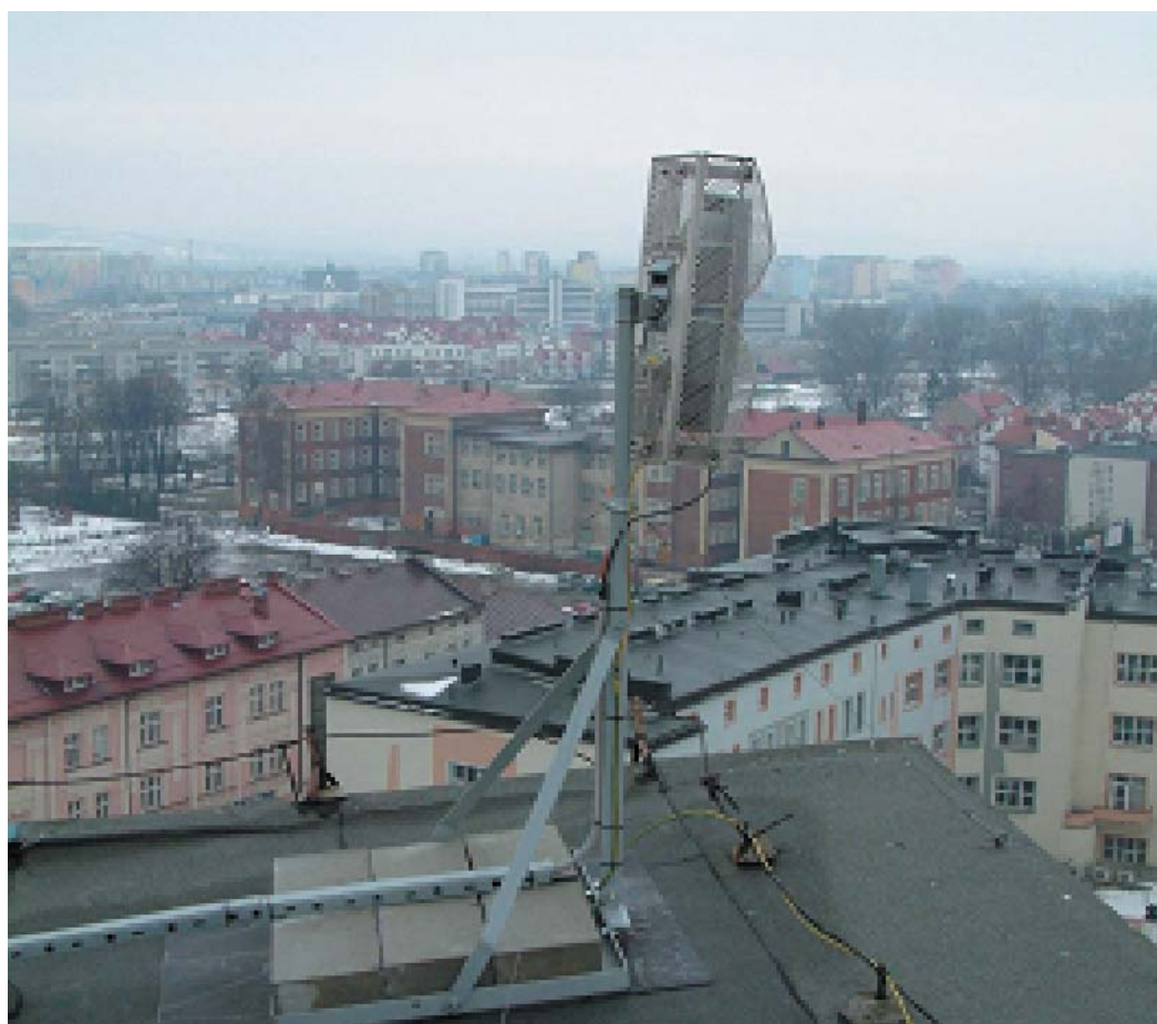
Na budynku urzędu są umieszczone nadajniki kierujące sygnał do szkół.
